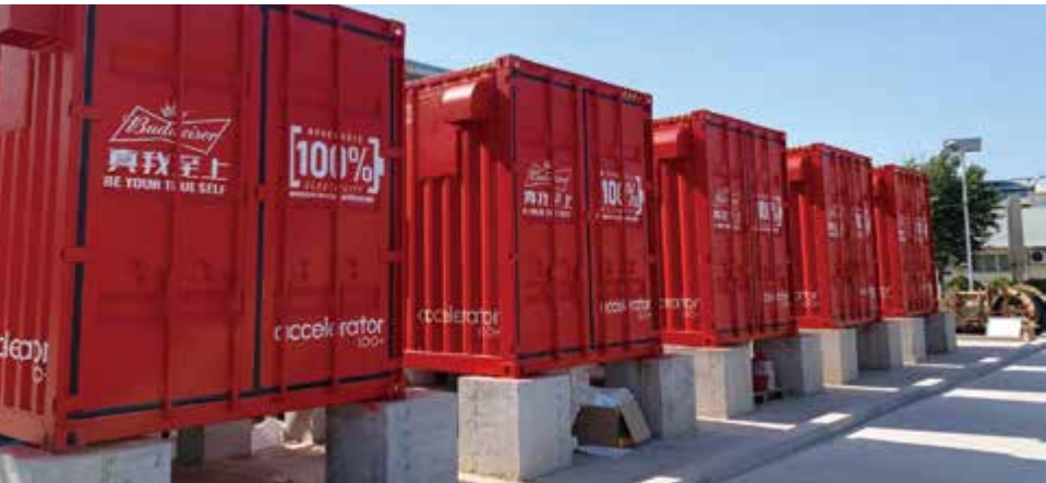
本行支持的某集装箱式削峰填谷电化学储能电站项目
